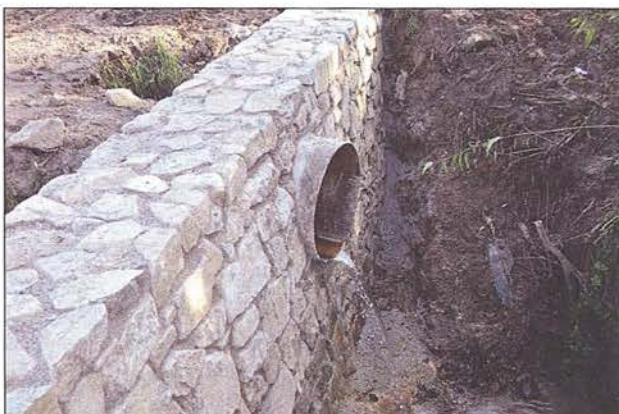
Protipovodňová nádrž s prepadom na Minarickom potoku na hranici intravilánu a extravilánu obce Stará Bystrica
